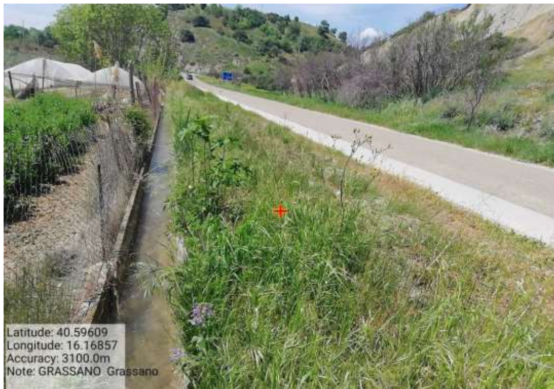
INTERVENTO 6.1.6.2 Grassano Fg.28-29-26-30-31 Canaletta Irrigazione - Distribuzione Principale Distretto 3 (tratto A) Foto n. 40
