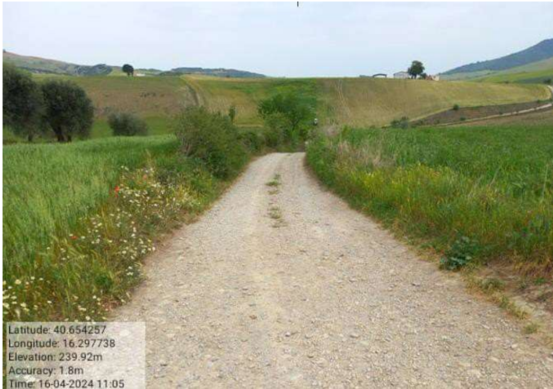
INTERVENTO 6.3.36.1 Tricarico Fg.29 Stara Comunale Calderaso 1° Tratto agro di Tricarico Foto n.76
