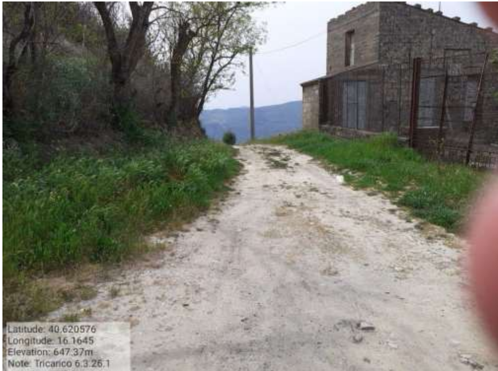
INTERVENTO 6.3.26.- TRICARICO EX COLLEGAMENTO BASENTANA FG.66-67
