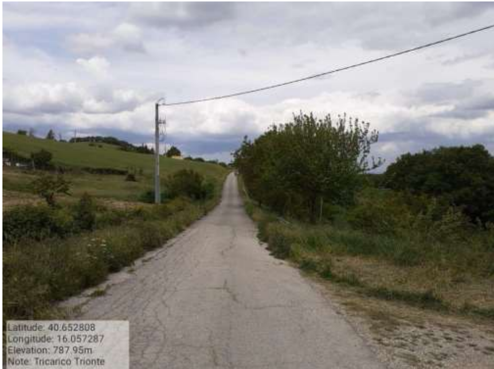
INTERVENTO 6.3.35.- TRICARICO STRADA COMUNALE TRIONTE FG19-19-20-31-32-42 Foto n.74
