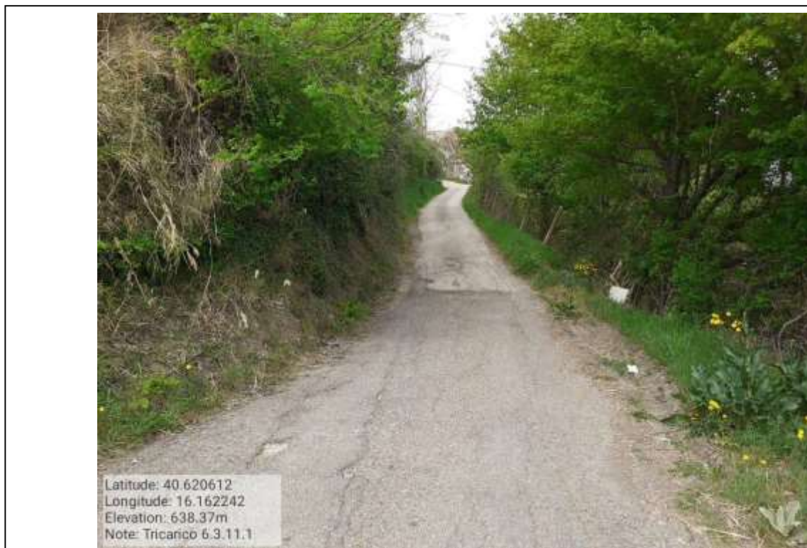
INT 6.3.11 - TRICARICO TRATTURO TRICARICO GRASSANO 1° TRATTO BIVIO TRICARICO CALLE FG.57 Foto n. 50
