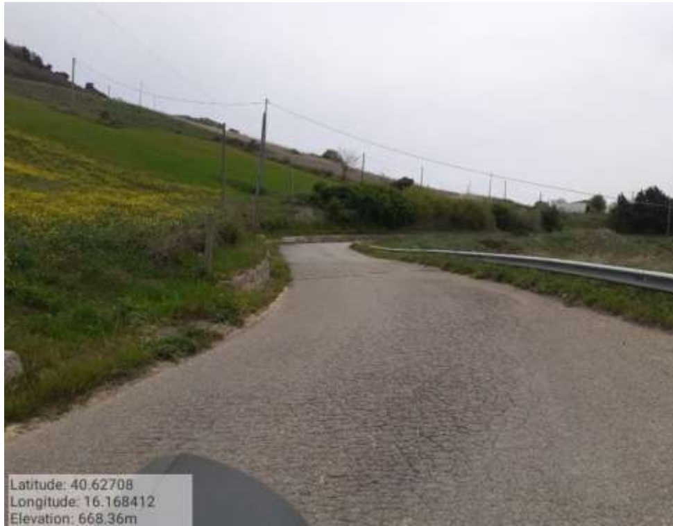
INTERVENTO 6.3.32- TRICARICO STRADA COMUNALE CACCIA NELLA NEBBIA FG.55-56-37-38-48-15 Foto n. 72
