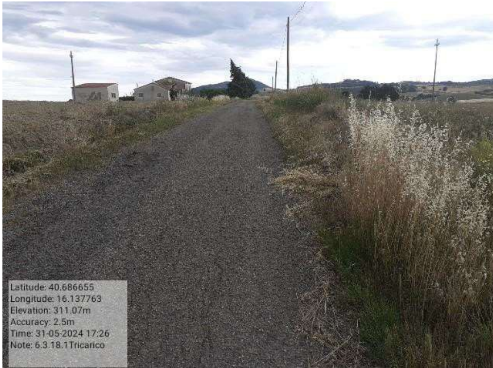
INTERVENTO 6.3.18.- TRICARICO STRADA COMUNALE FORTE ORLANDO FG.4
