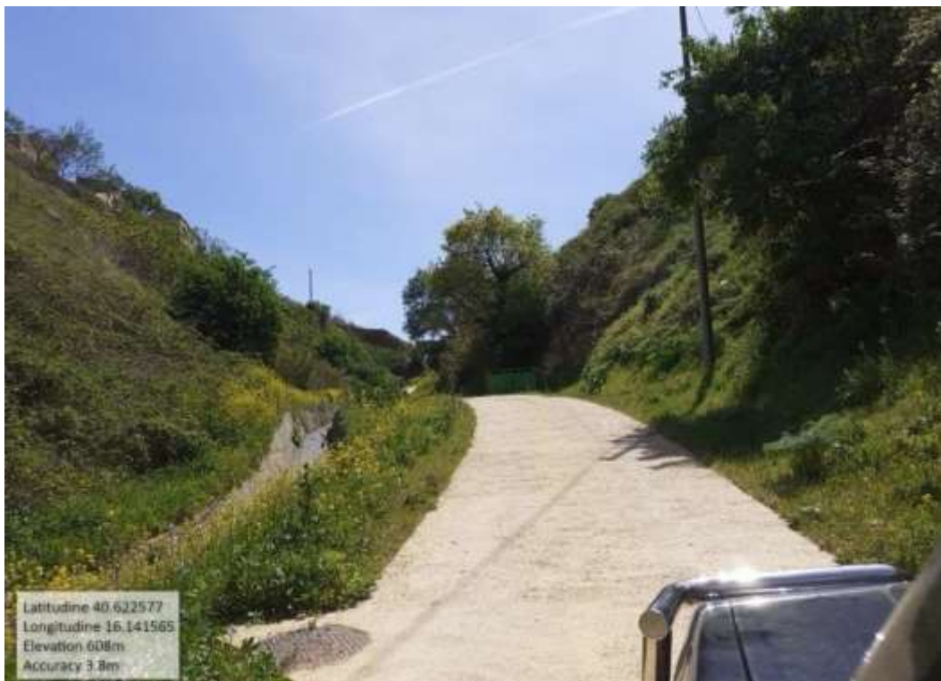
INTERVENTO 6.1.1- TRICARICO Fglio 65 part. Acque TORRENTE CACARONE TRATTO 2° Foto n. 30
